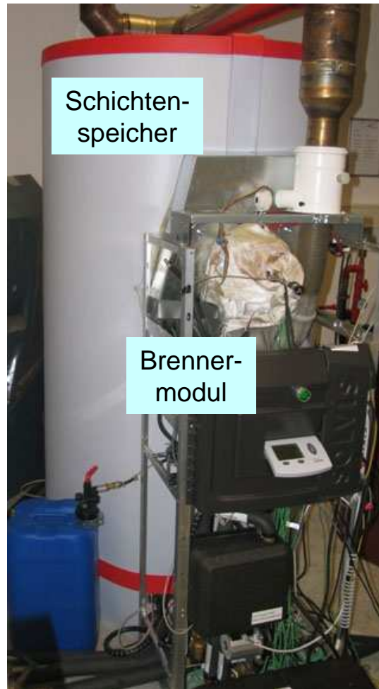
Warmwasser-Heizungsmodul mit Solvis-Schichtenspeicher
